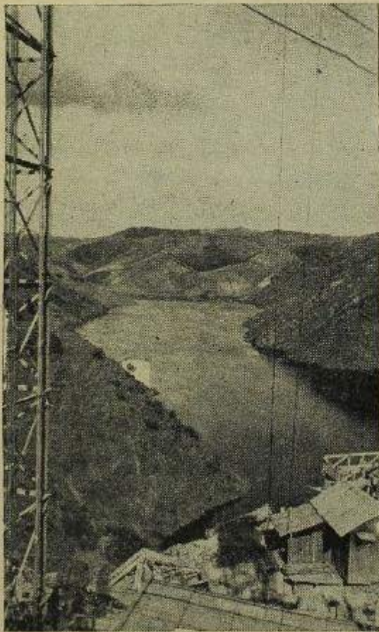
BARRAGEM DO CASTELO DO BODE. — A MASSA DE ÁGUA DO RIO ZÊZERE, REPRESENTADA, NA DATA DE 3 DE MAIO DE 1950.
